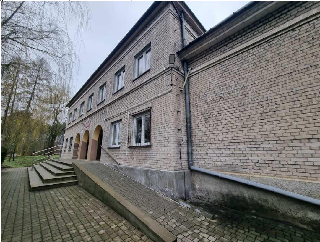
Fotografia 4. Brak izolacji na szkole w miejscowości Święte Laski
